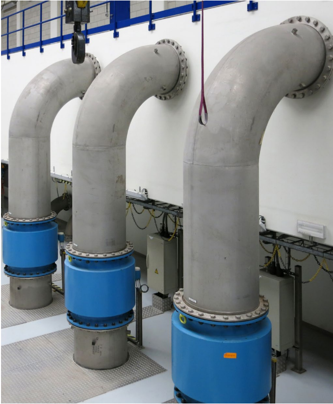
污水厂使用不锈钢可以有效抵抗腐蚀与磨损。 照片：欧洲不锈钢协会，布鲁塞尔，比利时
