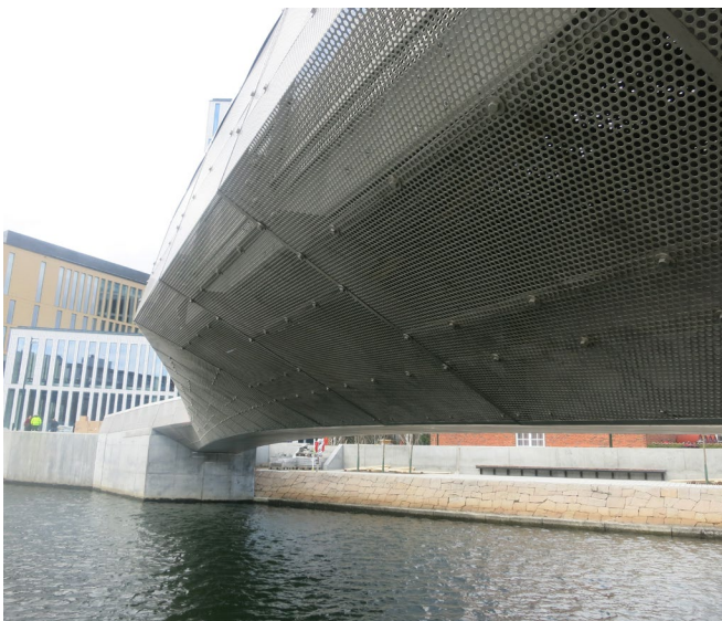
天桥是完全被预制后整体运输到施工现场的。 照片：Vistal Gdynia S.A., 格丁尼亚，波兰
